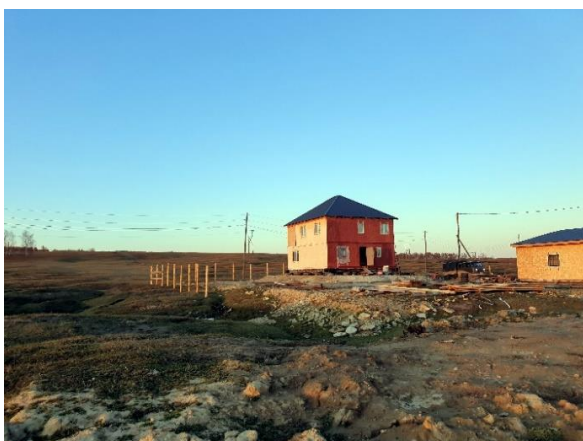
Рис. 36. Строительство домов на участках с активными термокарстовыми процессами. Отсыпка на фото обошлась, по словам владельца участка, более чем в 300 тыс. руб., с. Чапчылган, сентябрь 2022 г. Фото А.А. Сулейманова.
