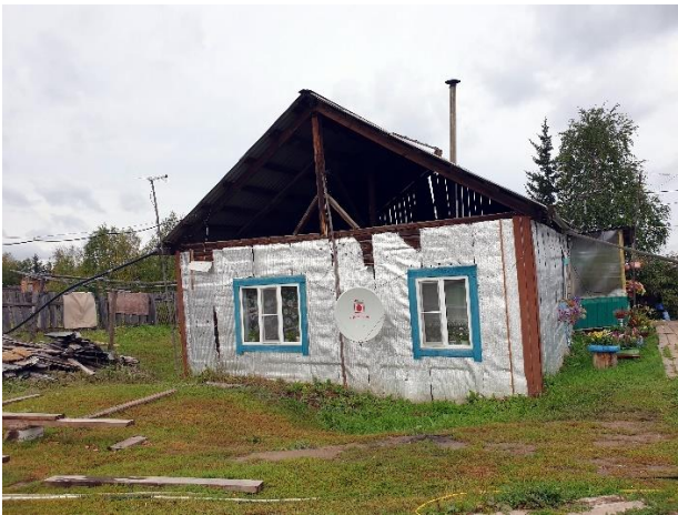
Рис. 25. Последствия деградации ММП: хозяйка этого дома вынуждена была взять кредит для строительства на новом месте и пересмотреть свои планы по выходу на пенсию, с. Юнкюр, сентябрь 2021 г. Фото А.А. Сулейманова.
