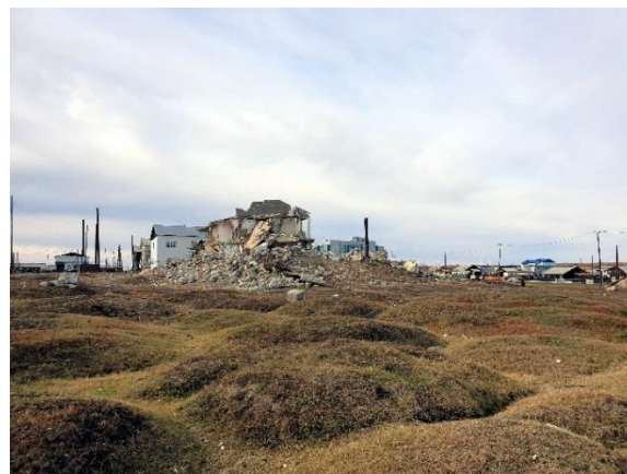
Рис. 45. Остатки построенного без свайного фундамента «Экспериментального дома», с. Амга, сентябрь 2021 г. Фото А.А. Сулейманова.
