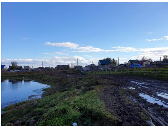
Рис. 32. Примеры деформации внутрипоселковых путей сообщения в с. Юнкюр, сентябрь 2021 г. Фото А.А. Сулейманова.
