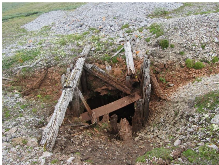
Рис. 2. Внешний вид разрушенной шахты с наличием отвалов свинцово-цинковой руды на водосборе реки Красной (июль 2023 г.).
